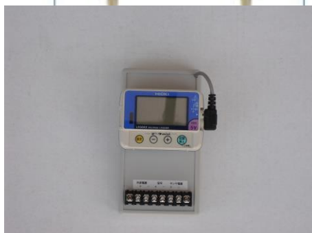
記録部・電源BOX
